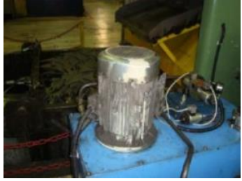
Soğutma Kulesi Motoru
